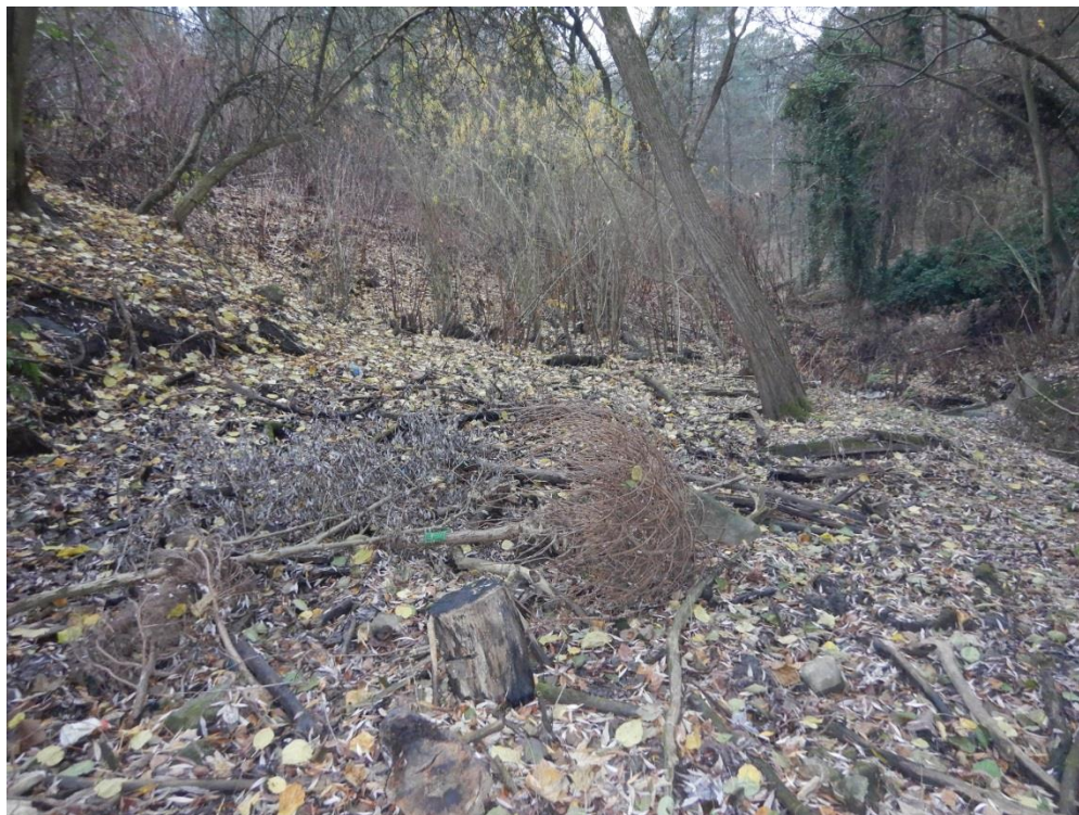
Fot. 1. Wypływy i wysięki z skarpy głównej osuwiska.
